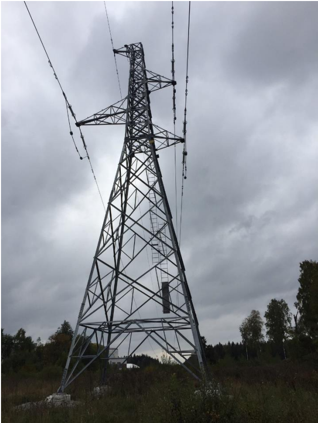
Figur 8. Fotoexempel på stål stolpe med fackverk och i raklinje.
