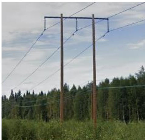
Figur 2. Foto på den befintliga 150 kV ledningen (källa Google Maps).
