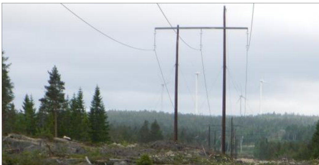
Figur 2. Exempel på 150 kV-ledning på tvåbent trästolpe (portalstolpe) med enkel topplina.
