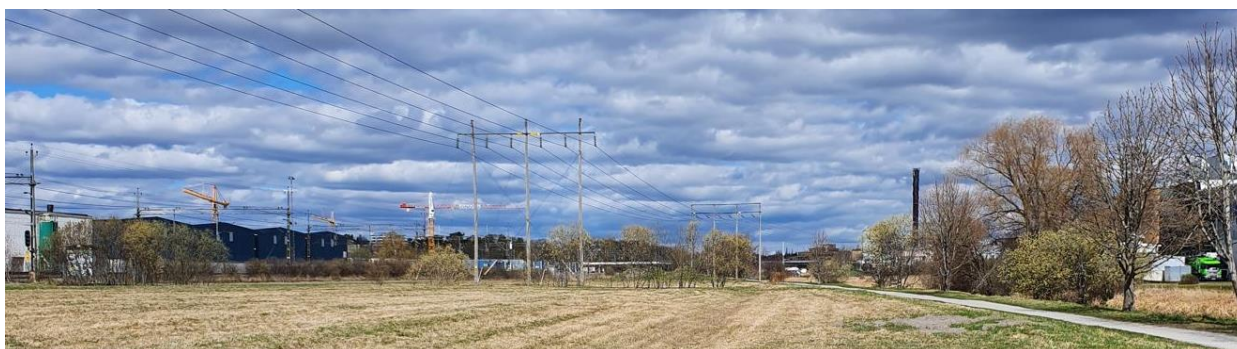
Figur 7. Foto på dagens 70 kV-ledningar.
