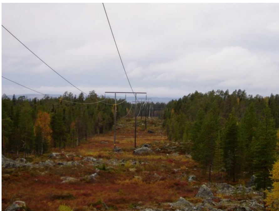
Figur 4. 130 kV luftledning i regionnätet, trädsäker.
