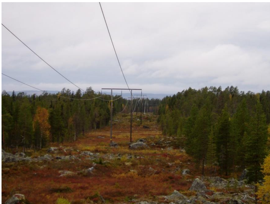
Figur 1. 130 kV luftledning i regionnätet, trädsäker.
