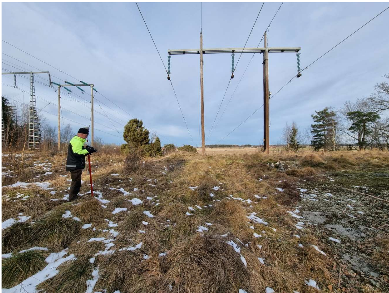
Figur 4. Vy över dagens ledningsgata med tre ledningar. Från vänster är det RL7 (Svenska kraftnät), ÄL76 (Vattenfall Eldistribution) och RL2 (Svenska kraftnät).
