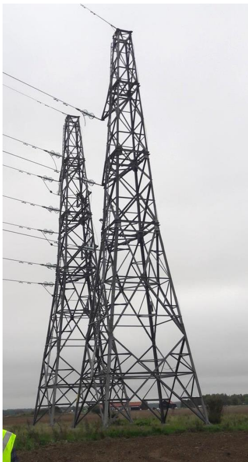
Figur 4. Befintliga kabelstolpar vid Brillinge. Den nya 132 kV ledningen planeras att gå från den högra kabelstolpen i bilden.
