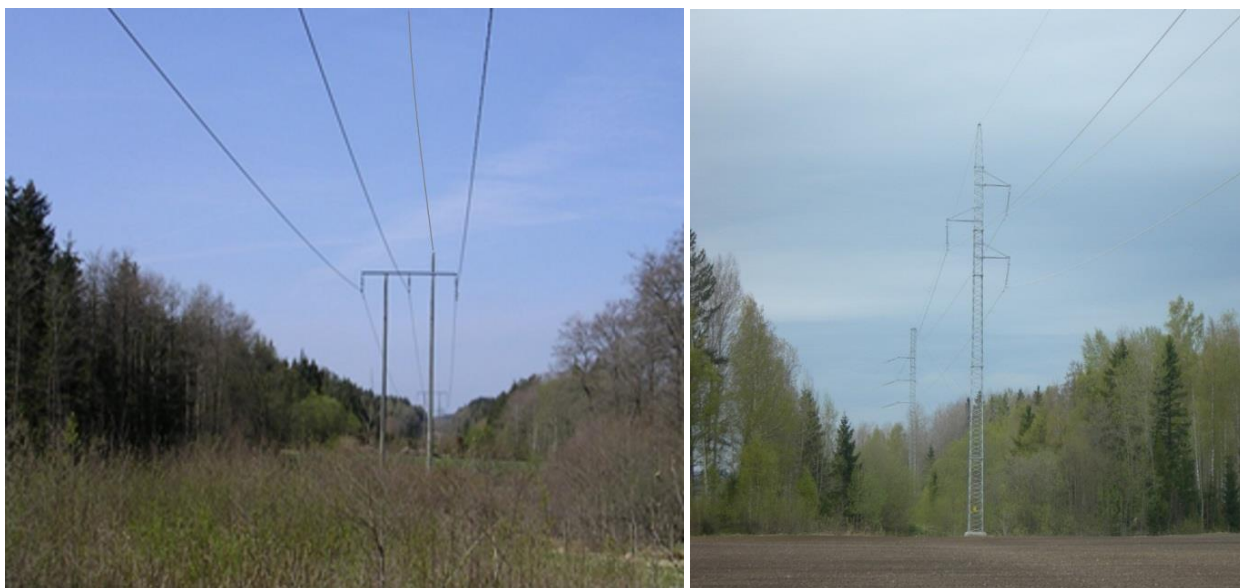
Figur 8. Till vänster: exempelbild på en portalstolpe med topplina. Till höger: exempelbild på en gitterstolpe.
