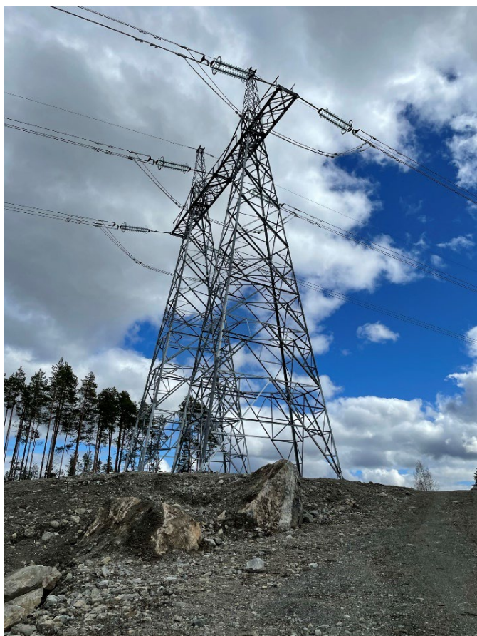
Figur 9. Bilden visar en s.k. ändstolpe som kan bli aktuell för 400 kV-ledningen.
