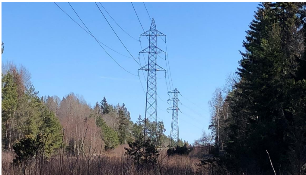
Figur 3. Foto på typ av stolpar mellan station Överby och stolpe 9 (Foto: Sweco).
