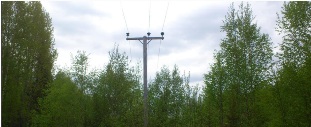
Figur 2. Exempel på 40 kV ledning.
