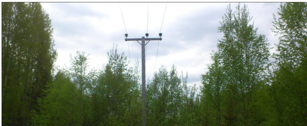
Figur 2. Exempel på 40 kV ledning.
