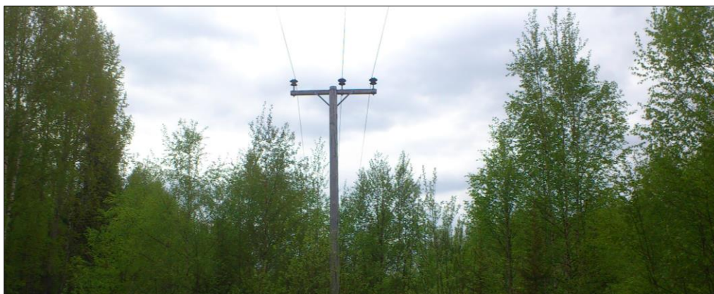
Figur 2. Exempel på 40 kV ledning.
