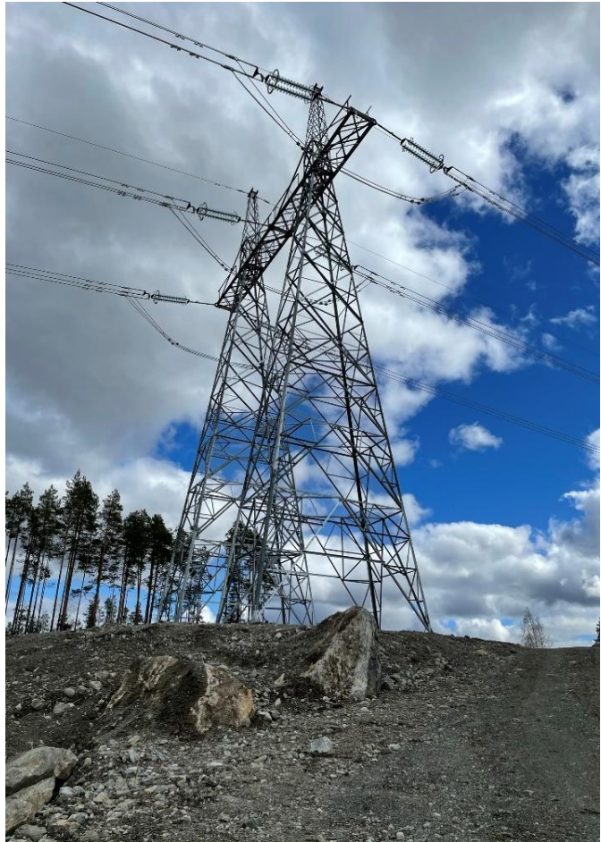
Figur 10. Bilden visar en s.k. ändstolpe som kan bli aktuell för 400 kV-ledningen.
