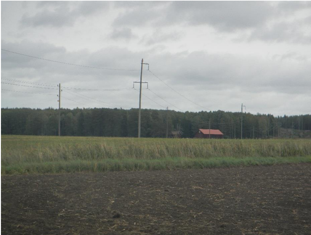
Bild 2. Foto över befintliga enkelstolpar av trä (i mitten av bilden) på sträckan Sala – Heby.
