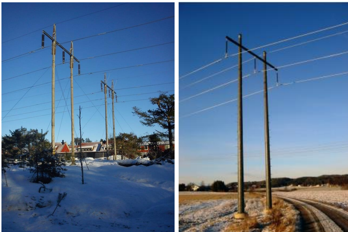
Figur 7. Första bilden visar exempel på två parallella ledningar i portalstolpe. Den andra bilden visar exempel på en ledning med portalstolpar i kompositmaterial
