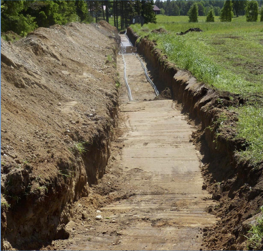
Figur 10. Exempel på dubbla kabelförband i kabelgrav.
