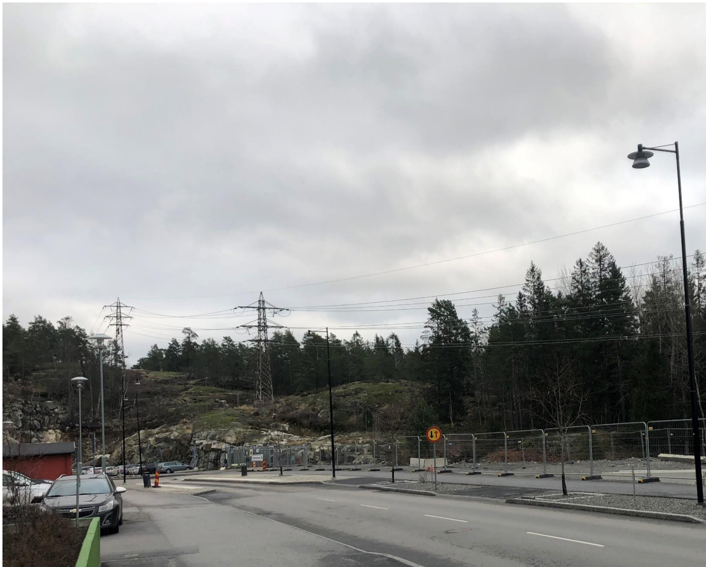
Figur 7. Ledningarna innan ombyggnationen. Rasering kommer att ske av stolpe och ledning närmast i bild. Bilden är tagen vid Tollarevägen i riktning mot öster.
