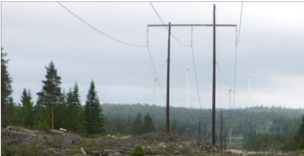
Figur 3. Exempel på 150 kV ledning med tvåbent portalstolpe och enkel topplina.
