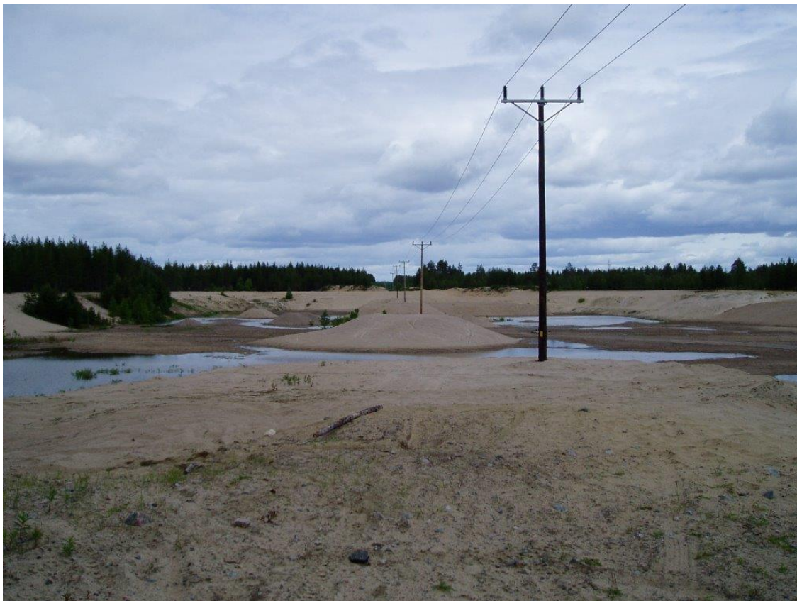
Figur 2. Exempel på 45 kV ledning med trästolpe.
