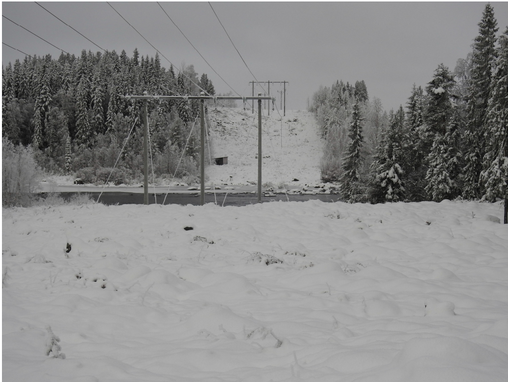
Figur 8. Bilden visar utgången från den nya stationen i Slagnäs. Motivet är i riktning mot Arjeplog, Vattnet i bild är Skellefteälven. Spänningen på befintliga ledningar är 40 kV.
